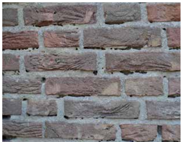
8.11 Beschadiging door wormkruidbijen aan een muur in Veenedaal (foto Arie Koster).
