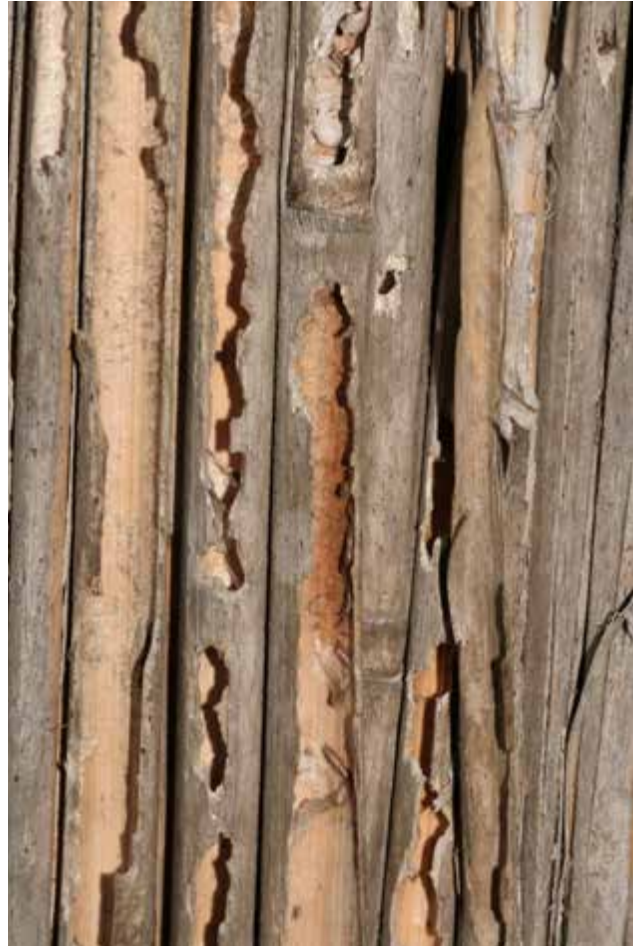
21.53 Rietmatten worden door mezen ook opengehakt.
